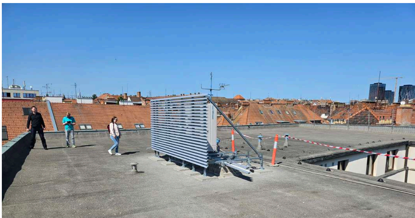
Kondenzační jednotky na střeše budovy Nejvyššího soudu.
